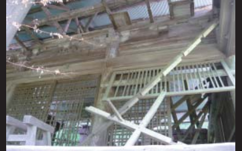
崩れて仮囲いがしてある建物
