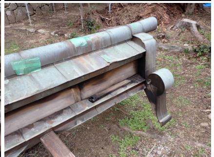
破損していない落雷部分の棟鬼
