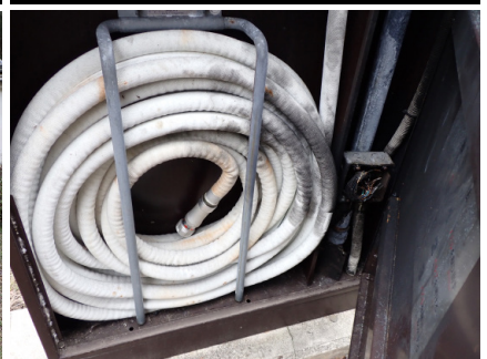
電気系統が被災した消火栓
