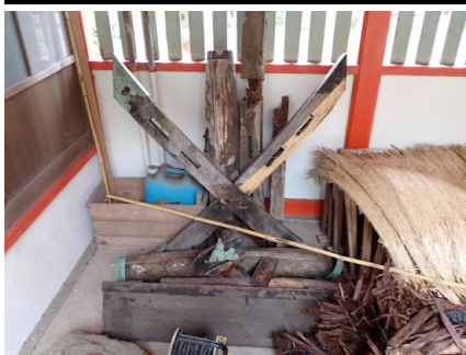
落雷部分の千木北東先端
